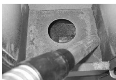
Fig. 26 - Limpieza alojamiento cajón de cenizas
