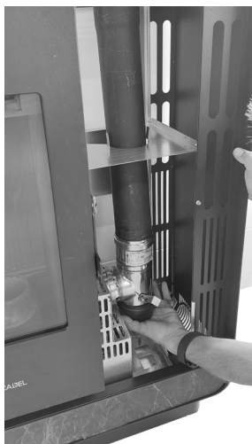
Fig. 54 - Fume conduit cleaning
